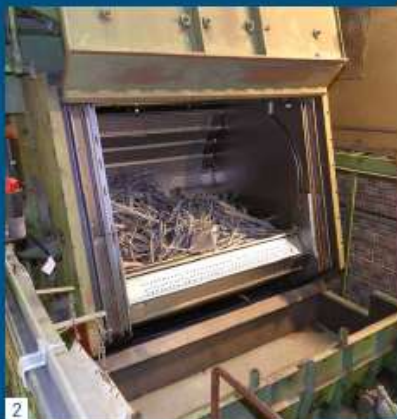
2 GEOPENDE STRAALTROMMEL MET TE STRALEN METAAL OPENED BLASTING CHAMBER WITH METALS TO BE DECONTAMINATED
