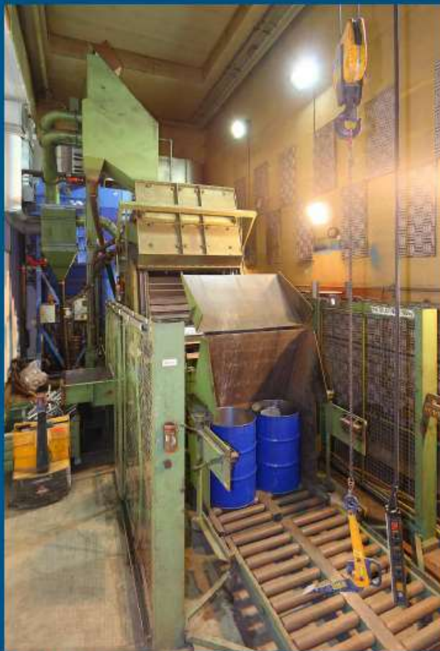
GLOBAAL BEELD VAN DE STRAALINSTALLATIE OVERVIEW OF THE BLASTING INSTALLATION
