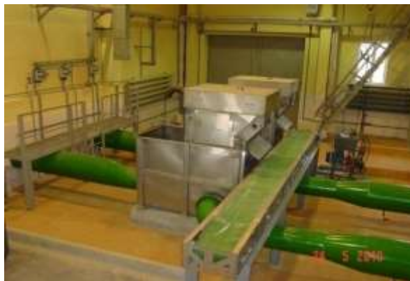
Блок механических решёток
