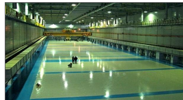
Введено в строй «сухое» долговременное хранилище ОЯТ на «ГХК» Уровень заполнения хранилищ – 49 %
